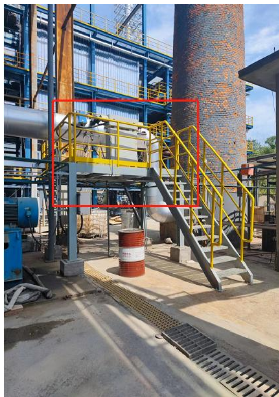
焚烧炉监测平台
